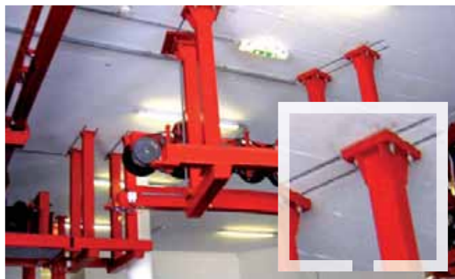
Крепление подвесной канатной дороги
